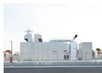
非常用発電機
