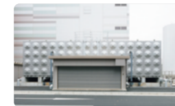
貯水 - 検査ラボ棟受水槽
