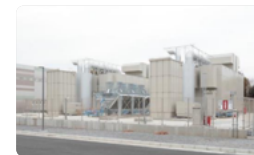
電力 - 非常用発電機
