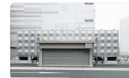
貯水 - 検査ラボ棟受水槽
