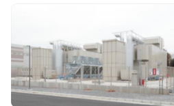
電力 - 非常用発電機
