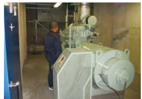
① A棟地下常設非常用発電機（500kW）
