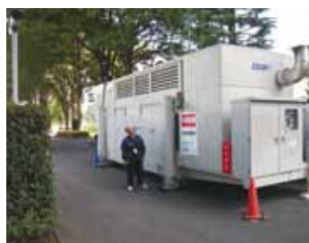
緊急用仮設非常用発電機 (1000kW)
