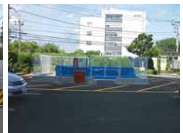
非常用発電機用屋外燃料貯蔵所
