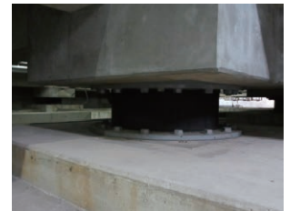
柱の下の黒い部分が積層免震ゴム
