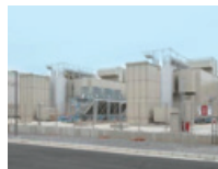
大規模な非常用発電機
